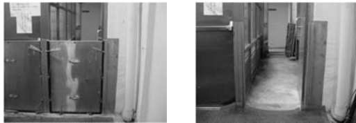
防水閘門(左圖：裝設前；右圖：裝設後)
