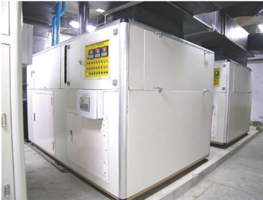
圖 29 化學除溼空調設備
