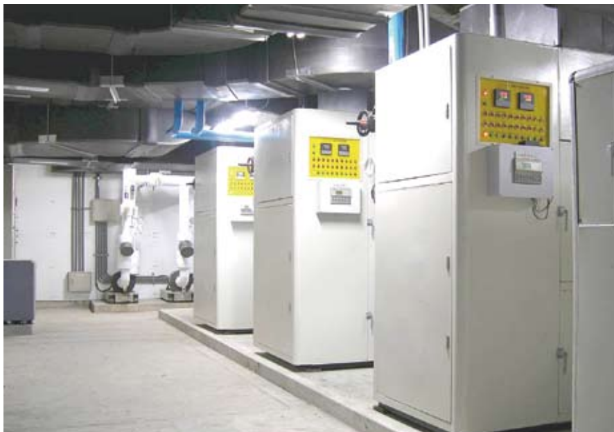
圖 30 恆溫恆溼空調設備
