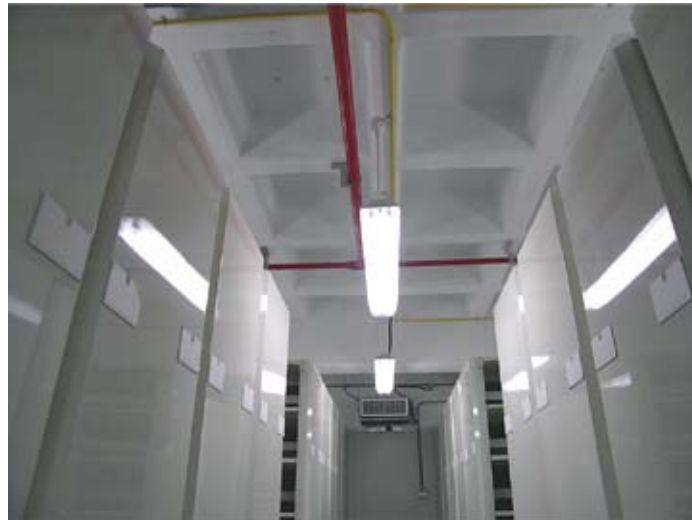
圖 14 不設懸吊式天花板 (紅色管線為消防管線、黃色管線為電力管線)
