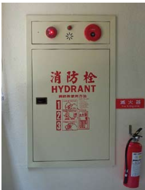
圖 51 一般消防消防栓箱及手提式滅火器
