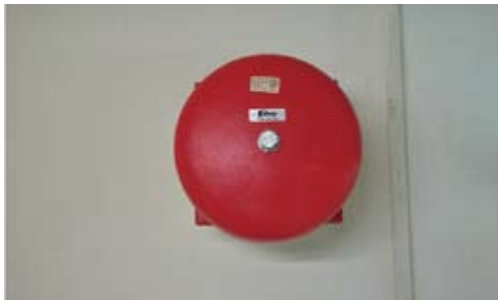
圖 45 自動氣體滅火系統警報器
