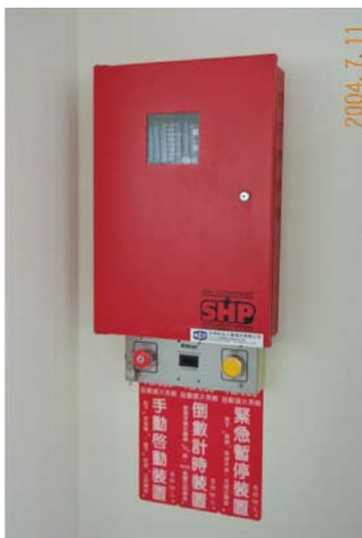
圖 49 自動氣體滅火系統控制箱
