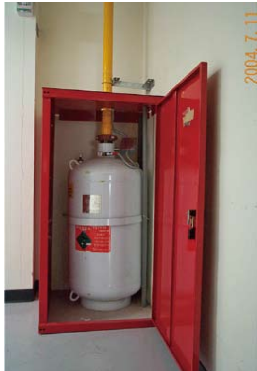
圖 47 自動氣體滅火系統鋼瓶
