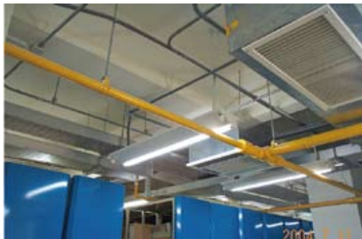
圖 46 自動氣體滅火系統管線 (黃色)
