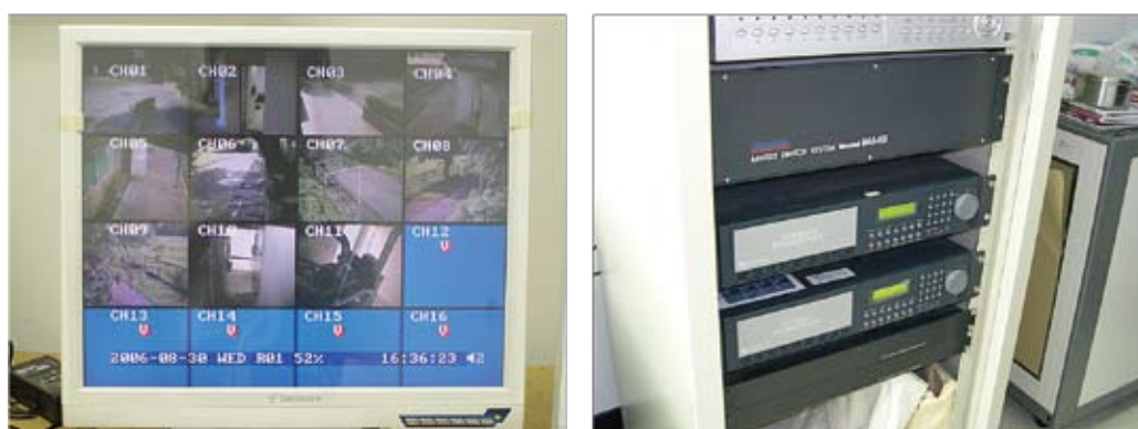
圖 72 錄影監視設備
