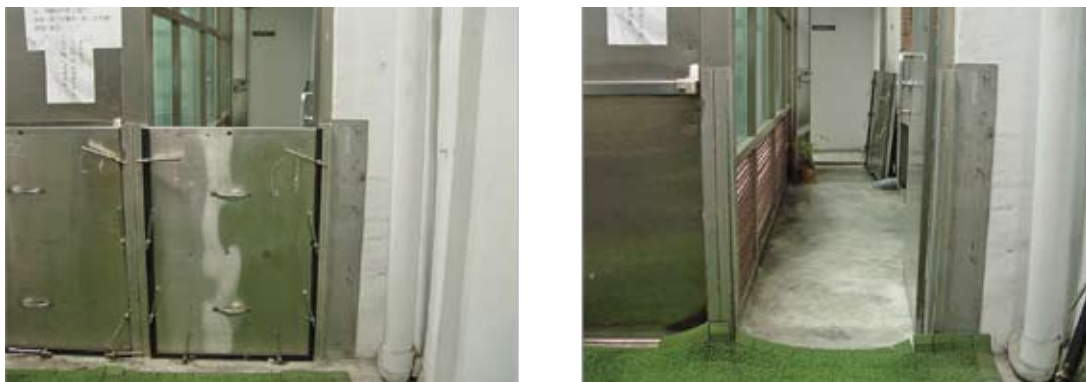
圖 55 防水閘門 (左圖：裝設前；右圖：裝設後)
