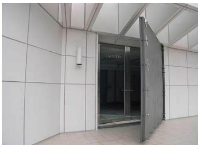
圖 54 國家檔案典藏場所正門口防水閘門
